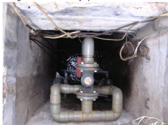
Gambar 3. Tempat Pompa Sirkulasi IPAL Lama
